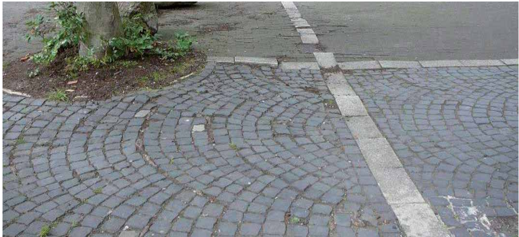
Abb. 49: Erneuerungsbedürftiges Pflaster im historischen Ortskern
