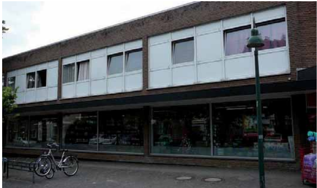
Abb. 30: Sanierungsbedürftiges Gebäude an der Brinkstraße
